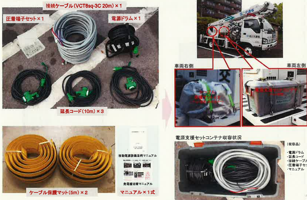
移動用電気工作物の車両（照明車等）への装備品常時搭載の実施例
