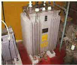
変圧器 (トランス)
