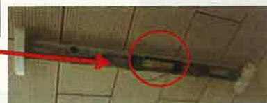
蛍光灯の安定器
