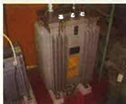
変圧器 (トランス)
